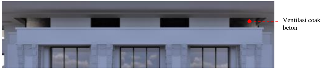
Gambar 9. Ventilasi Pada Bagian Kepala Gedung Merdeka
