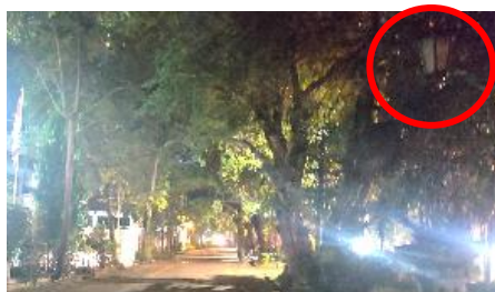
Gambar 12. Instalasi lampu tidak menyala di malam hari
