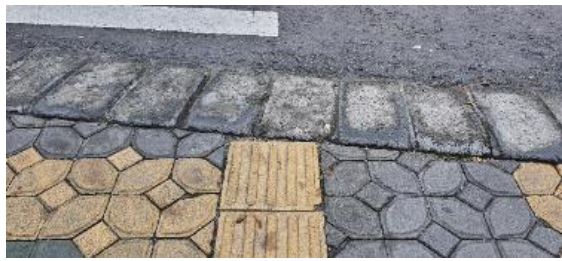
Gambar 8. Blok pengarah terputus dan tidak ada blok peringatan
