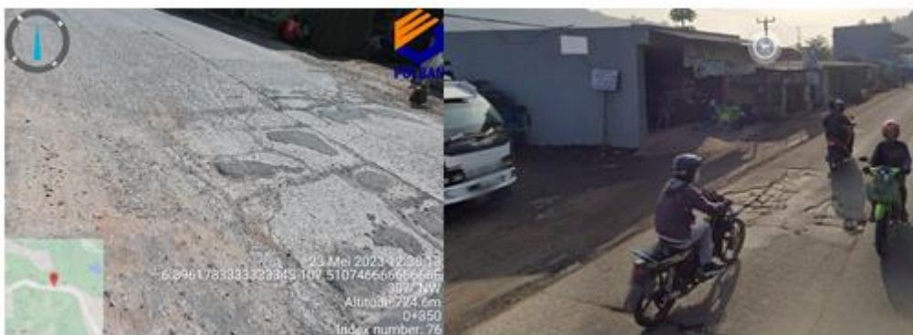
Gambar 1. Kerusakan jalan di ruas jalan Cangkorah Kabupaten Bandung Barat
