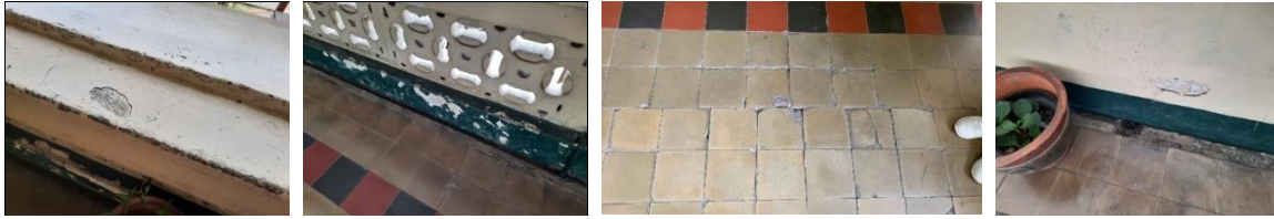
Gambar 14. Dinding Railing Koridor Semiindoor SMAN 5 yang Rusak (kiri, kiri tengah)
