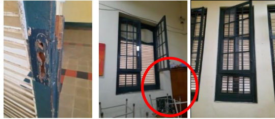
Gambar 5. Kondisi Pintu Kelas XII-C (kiri)
