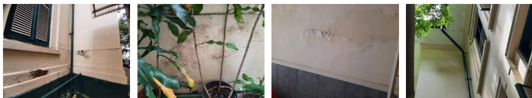
Gambar 33. Kerusakan pada Permukaan Dinding, Fasad Kiri (kiri), Fasad Belakang (kiri tengah, kanan tengah)
