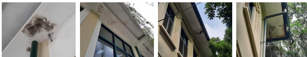
Gambar 36. Kondisi Plafon yang Rusak, Plafon Gypsum di Atap Belakang Bangunan (kiri, kiri tengah), Plafon Tripleks di Atap Kanan Bangunan Lama (kanan tengah, kanan)
