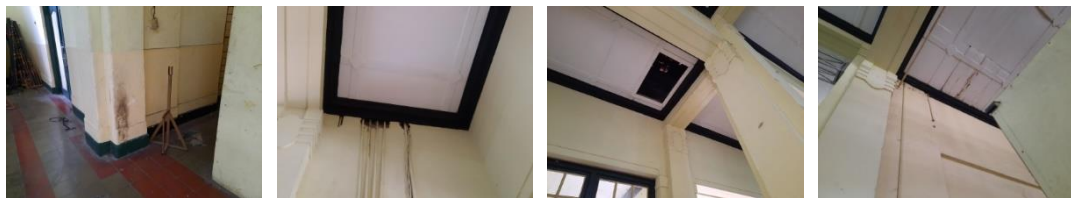
Gambar 22. Kondisi Salah Satu Kolom yang Kotor Bernoda (kiri) Gambar 23. Kondisi Dinding Berlubang pada Area Jalur Vetikal Kabel (kiri tengah) Gambar 24. Plafon yang Lubang Tanpa Panel (kiri), Plafon yang Bernoda (kanan)
