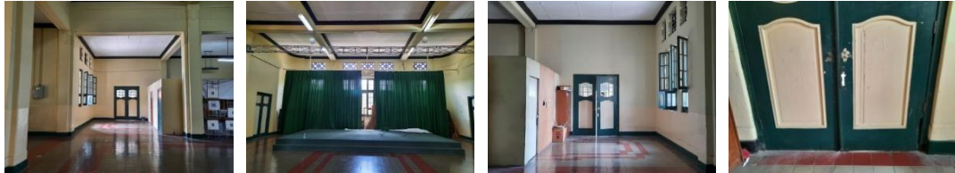
Gambar 20. View dari Hall Lantai 2, ke Arah Akses Koridor Semiindoor SMAN 3 (kiri), ke Arah Panggung Nonpermanen (kiri tengah), ke Arah Akses Koridor Semiindoor SMAN 5 (kanan tengah) Gambar 21. Kondisi Pintu Akses ke Koridor Semiindoor SMAN 5 yang Rusak (kanan)
