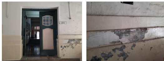
Gambar 29. Kerusakan pada Dinding di Area Pintu Entrance Lobi Koridor Belakang
