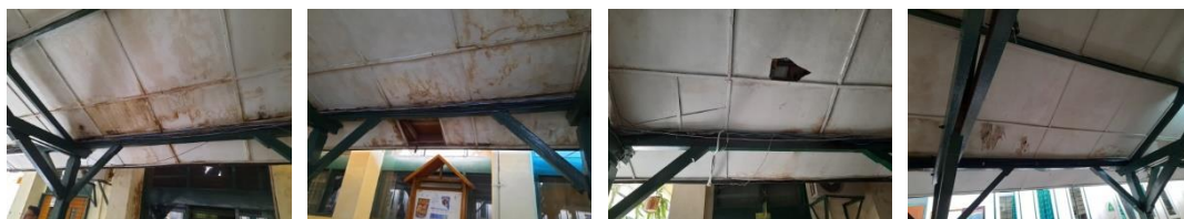
Gambar 31. Kerusakan pada Plafon Atap Koridor Belakang
