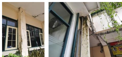
Gambar 35. Kolom di Belakang Bangunan yang Rusak
