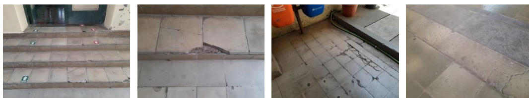
Gambar 30. Kerusakan pada Lantai, di Area Pintu Entrance Lobi Koridor Belakang (kiri, kiri tengah, kanan tengah), di Koridor (kanan)
