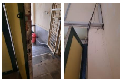
Gambar 12. Pintu Entrance Siswa SMAN 5 yang Rusak (kiri)
