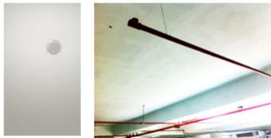
Gambar 10 - Sprinkler pada koridor apartemen dan sprinkler pada basement (Sumber: Data survey lapangan , 10/11/14)
