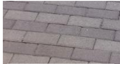
Paving block pola pasangan bata.
