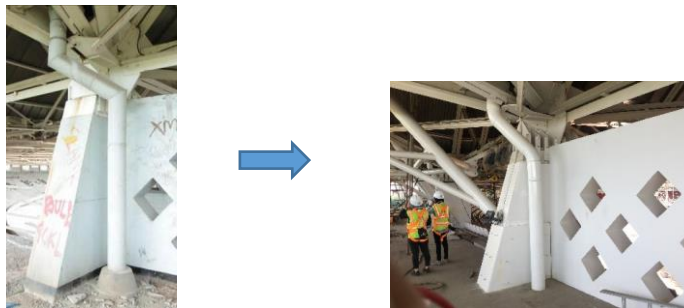
Gambar 29 dan 30. Kondisi Talang Vertikal 01 sebelum dan setelah perubahan.
