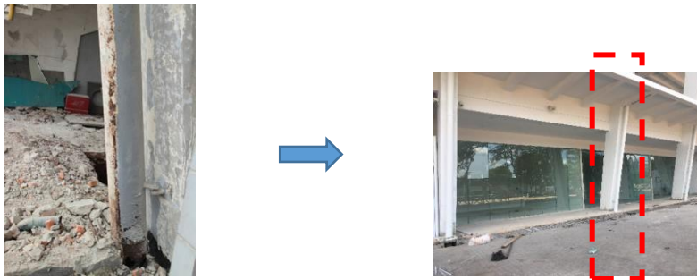
Gambar 31 dan 32. Kondisi Talang Vertikal 02 sebelum dan setelah perubahan.
