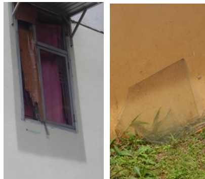
Gambar 3. Kondisi Kaca yang Rusak pada Rusunawa Cingised (Sumber : Survey 22/09/2015)
