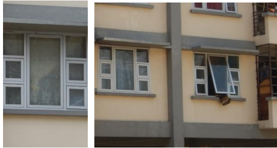
Gambar 4. Kondisi Kusen Aluminium pada Rusunawa Cingised (Sumber : Survey 22/09/2015)
