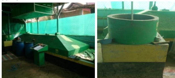
Gambar 2 Kondisi Biodigester Cibangkong
