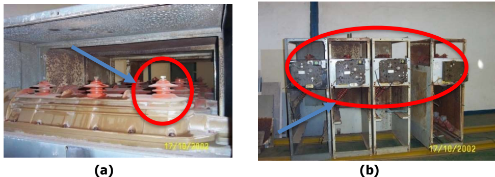
Gambar 1. Tampak Konstruksi Kubikel 20 kV (a) Tampak Bagian Isolator Tumpu Kubikel (b) Tampak Kerangka Kubikel setelah Terjadi Kerusakan
