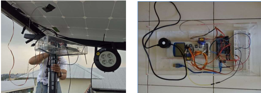
Gambar 5. Rangkaian Alat dan Instalasi Alat Ukur Parameter Utama Instalasi FV
