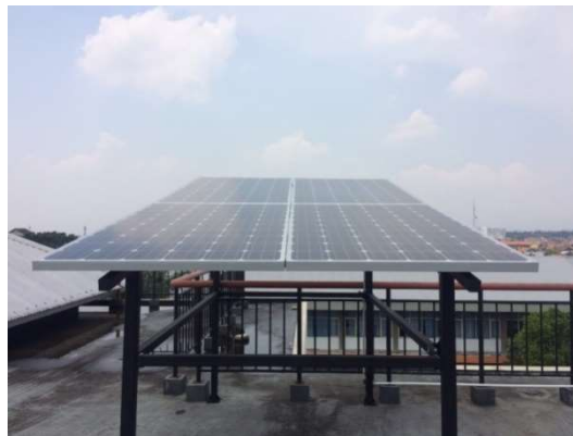
Gambar 2. Instalasi FV PLTS Institut Teknologi Nasional, Bandung
