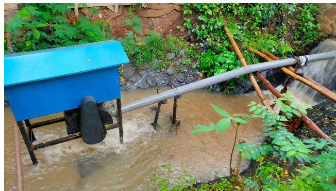
Gambar 12. PLTPH yang Terpasang
