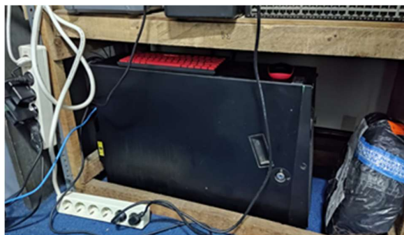
Gambar 9. Edge Server di Ruang Workshop FMIPA
