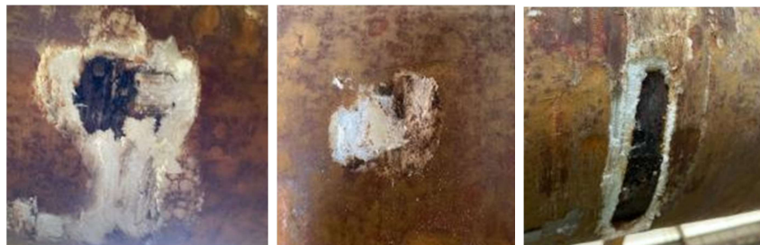
Gambar 9. Kerusakan pada Free Area Tail Shaft
